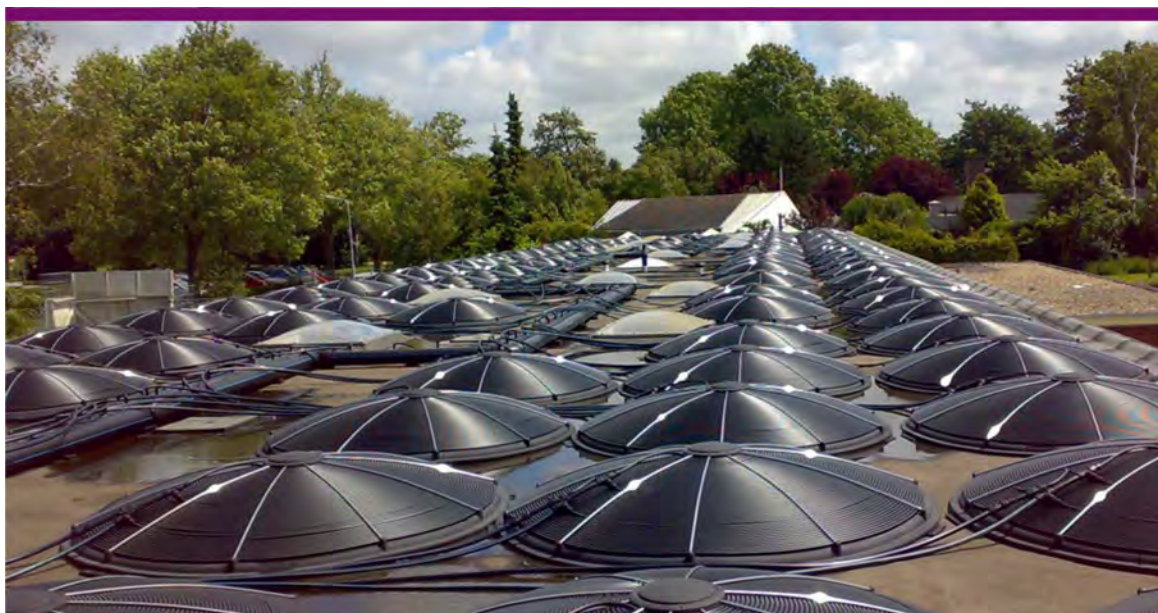
Zonnecollectoren op het dak (Baafje)
