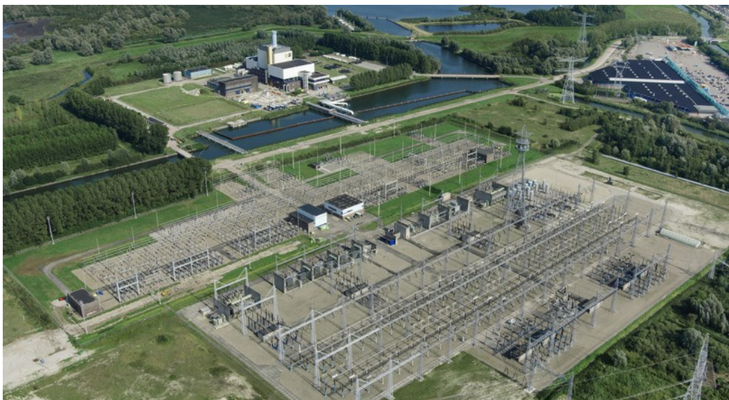
Figuur 2.5 Beeld 380/150 kV-hoogspanningsstation in Diemen (circa 16 hectare) (bron: TenneT)
