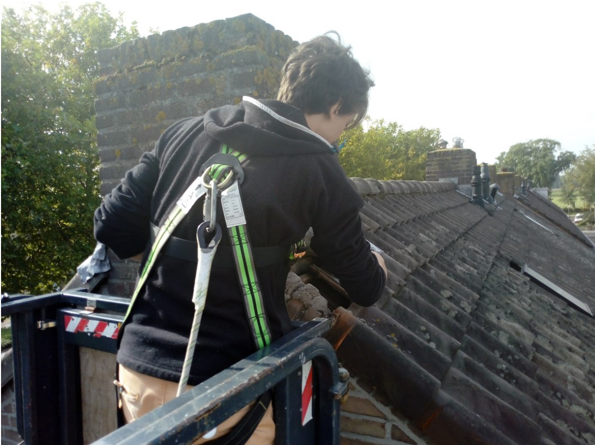
Visuele inspectie van een dak door een ecooloog gericht op het vinden van verblijfplaatsen (Bron: Arcadis).
