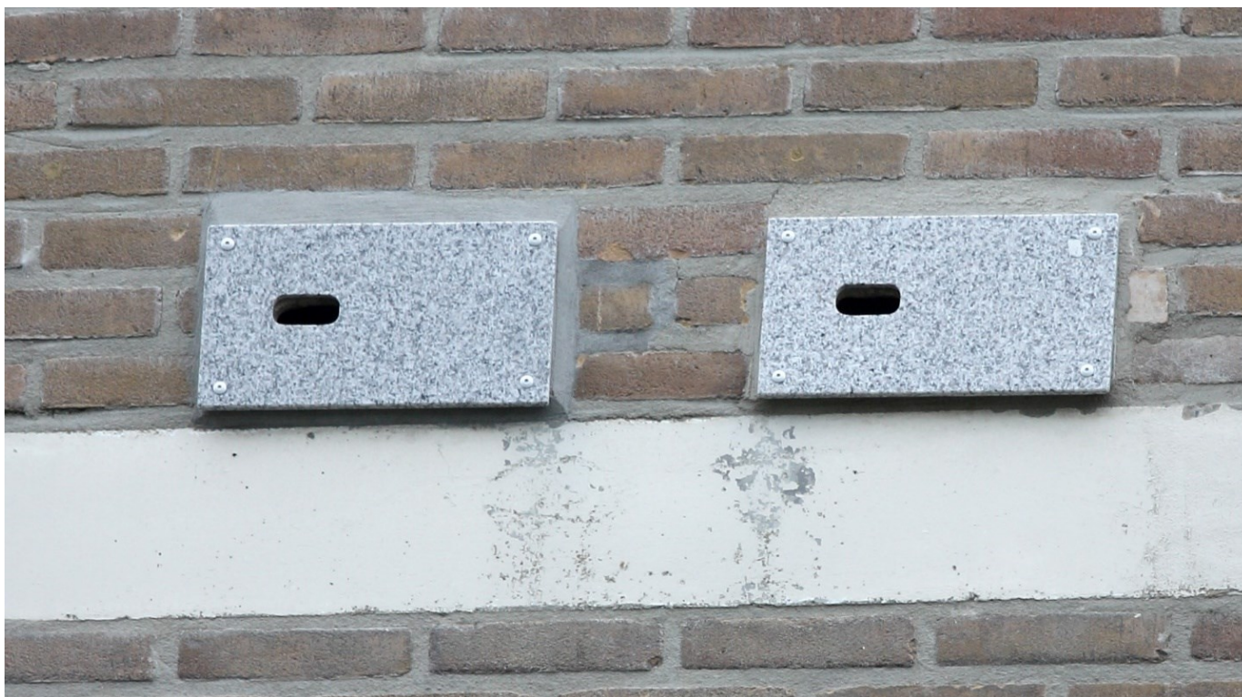
Halsbandparkieten die gierzwaluwkasten kraken, Als oplossing kan een marmerenplaat toegevoegd worden over de kasten (Bron: Vivara Pro)
