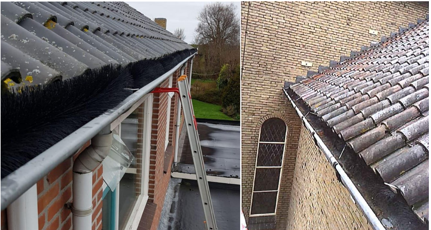
Figuur 6 Voorbeelden ontmoediging dakrand bij dakgoot link spouwborstel in de dakgoot (bron: Unitura.nl) rechts spouwborstel onder dakpannen (Bron: Arcadis)
