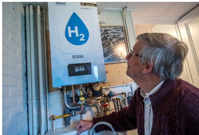
Een waterstofketel is qua maatvoering en aansluitingen vergelijkbaar met een cv-ketel op aardgas. Dat maakt vervanging tamelijk eenvoudig.
