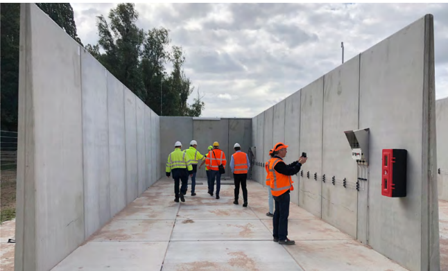
Opstelplaats voor tubetrailers met betonnen keerwanden.
