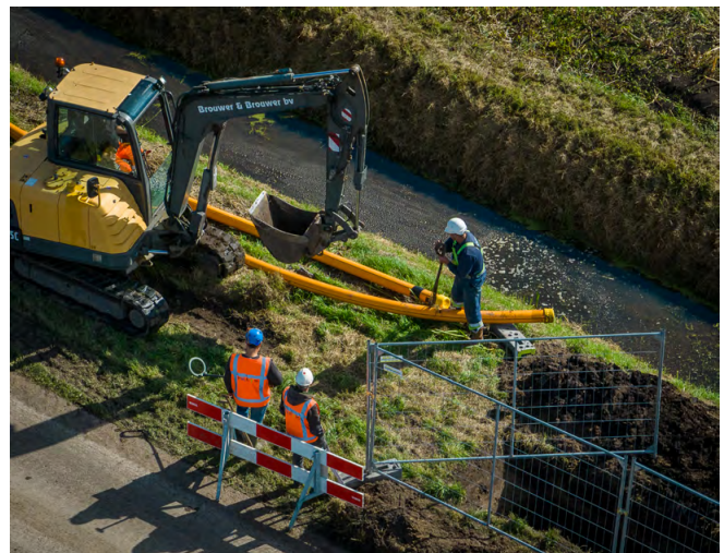
Bij graafwerkzaamheden is een Eis-Voorzorgmaatregel gezet op een Klic-melding. Dat betekent dat er alleen onder toezicht in de buurt van waterstofleidingen gegraven mag worden.
