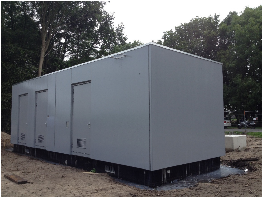
Figuur 3.1 Voorbeeld schakelkast
