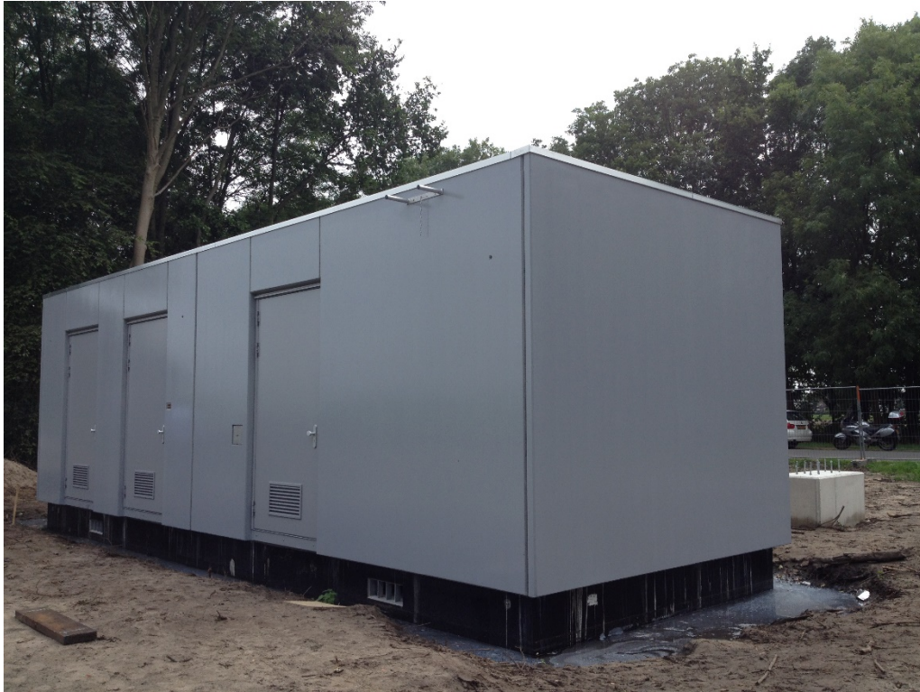
Figuur 3 Foto voorbeeld schakelkast
