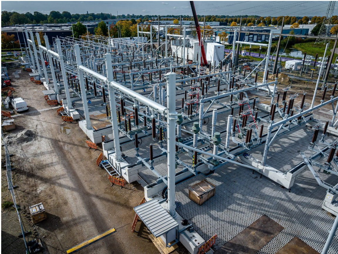
Figuur 1: Voorbeeld van een 150 kV-hoogspanningsstation
