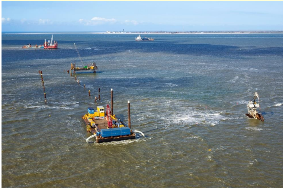
Afbeelding 22. Uitvoering van een HDD onder de NGT-leiding (met moflocatie, baggerwerkzaamheden en kabelinstallatie met wadtrencher)
