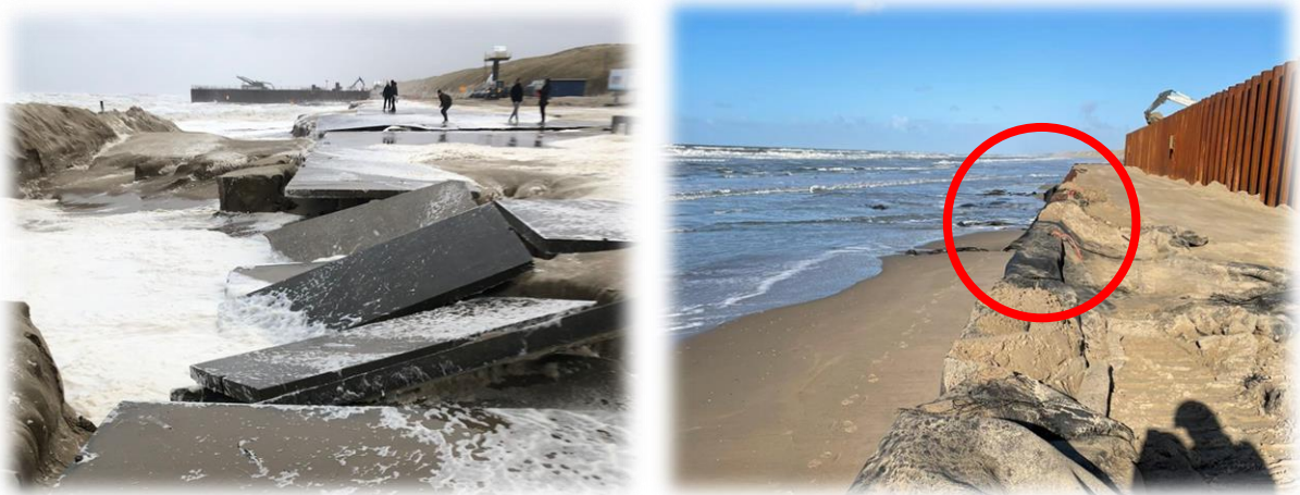
Afbeelding 23: Schade aan looppaden links na passeren Eunice, erosie voor constructie rechts na passeren Eunice (HKNwA).
