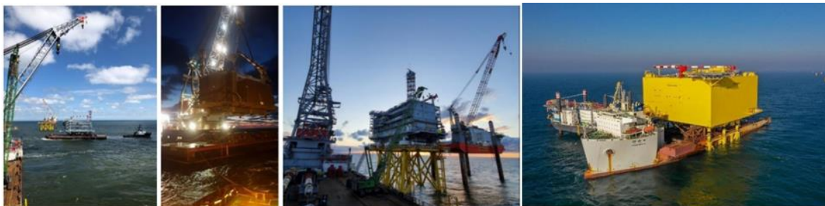
Figuur 12 Plaatsen van de topside door middel van een kraan (drie afbeeldingen links) of door deze over de jacket te varen (foto rechts)
