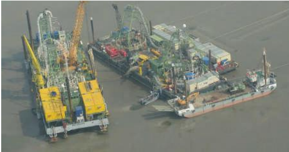
Figuur 4-2 Installatie in ondiepe zeegebieden in de kustzone
