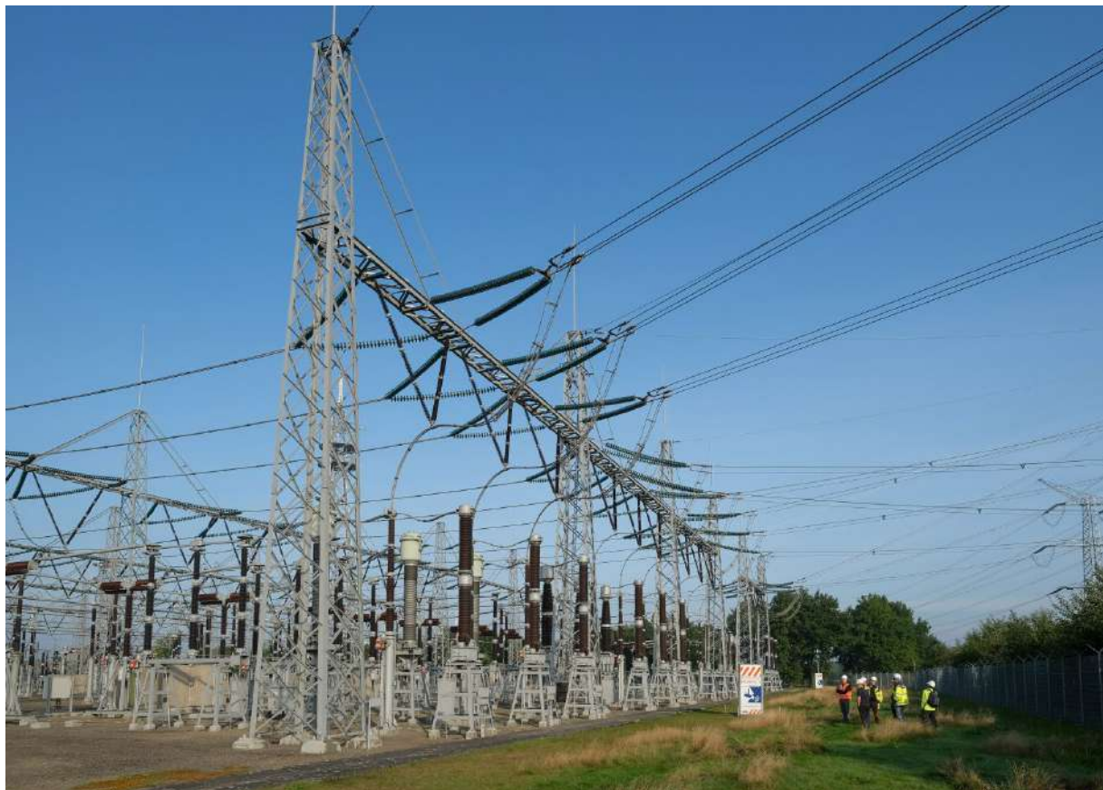
Figuur 1 G-portalen in onderstation EHV (sept. 2021) Afgebeeld is het noordelijke circuit WIT
