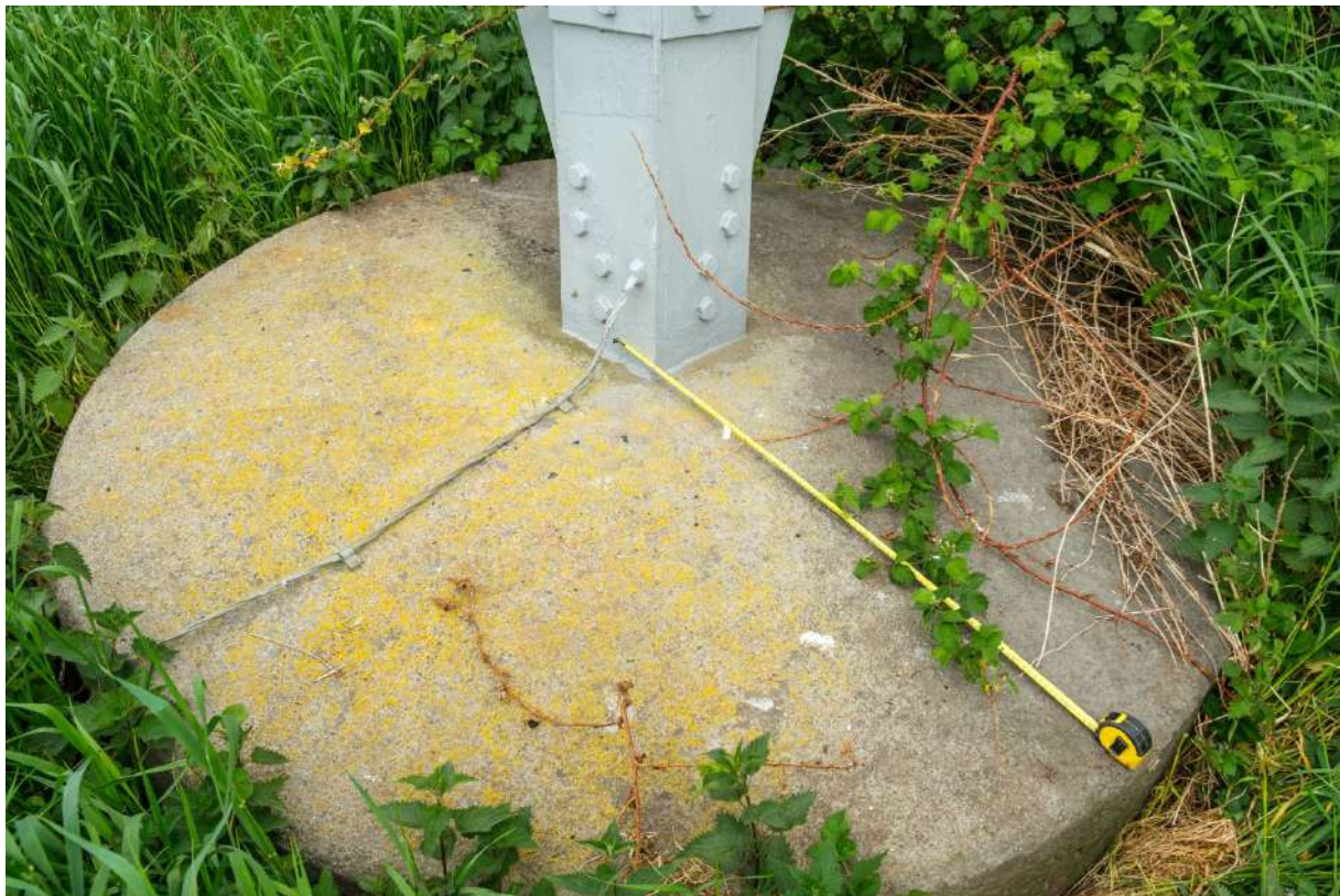
Figuur 3-10 Vierpaalspoer mast 82 met bovenafmeting 2,2 m
