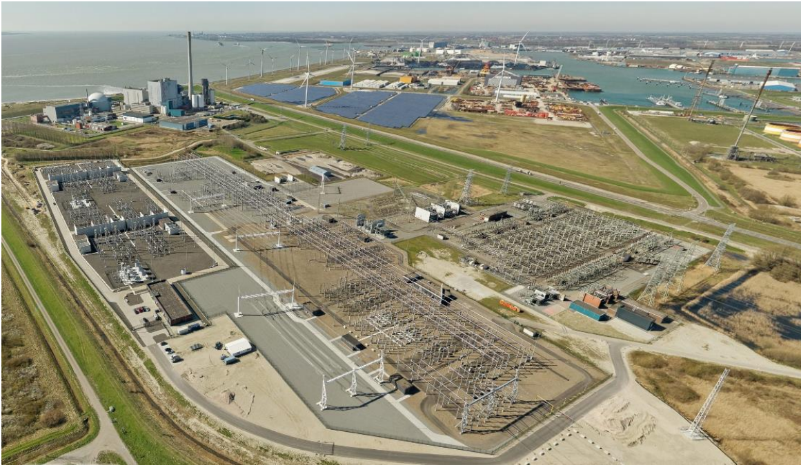
Figuur 6 Huidige situatie van het 380kV-station Borssele.
