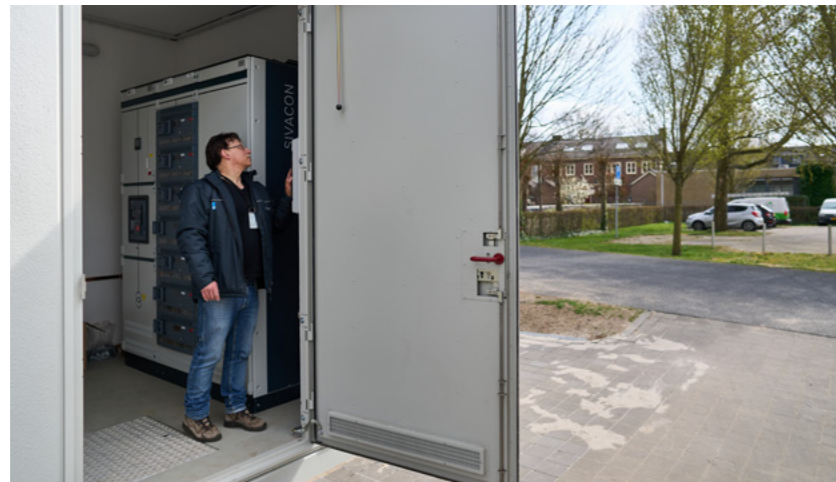
Nieuw transformatorhuisje voor het opladen van het elektrisch wagenpark bij de NWWA in Wageningen.
