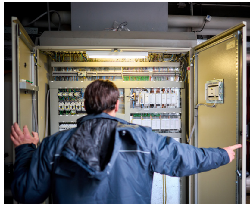
Het vervangen van bedrading in meterkasten maakt uitbreiding mogelijk.
