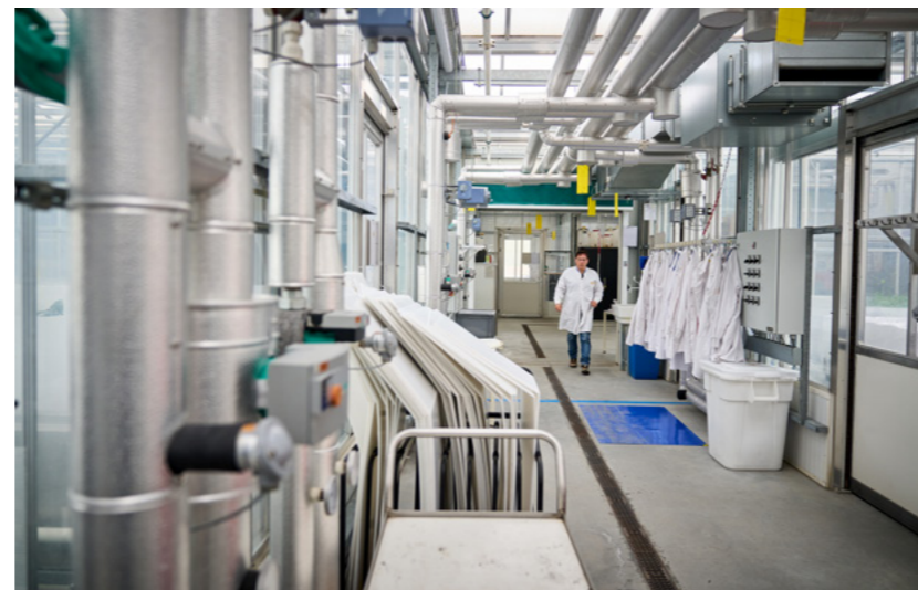
Nieuwe duurzame buizen en pompen in het laboratorium van de NWWA in Wageningen.
