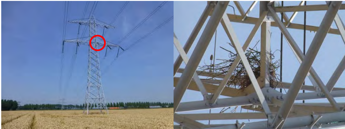
Figuur 5.4. Aangetroffen buizerdnest op de te verwijderen mast 22N, nabij mast 1017.
