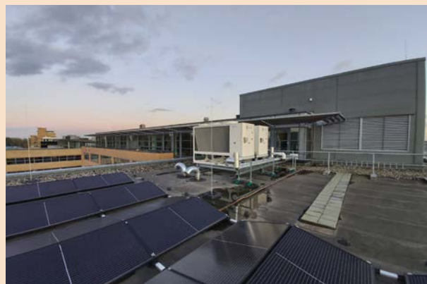
De nieuwe koelmachines en zonnepanelen op Meander 601 te Arnhem (Credits: Energy Bridge)
