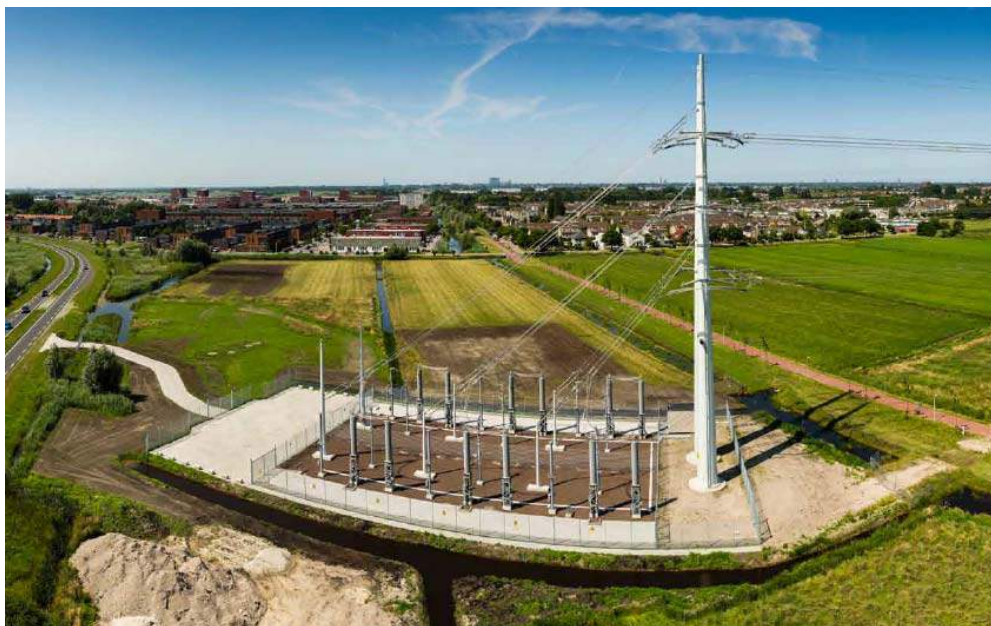
Figuur 11: Opstijpunt Pijnacker langs de N470 (richting hoogspanningsstation Bleiswijk)
