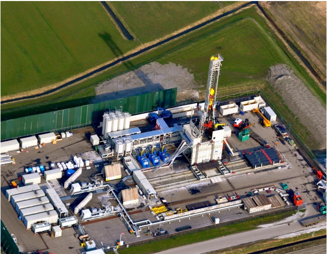
Figuur 2-2 Boorinstallatie inclusief boortoren en geluidswanden, zoals deze op de productielocatie eruit zal zien. Deze installatie staat meestal enkele maanden op locatie
