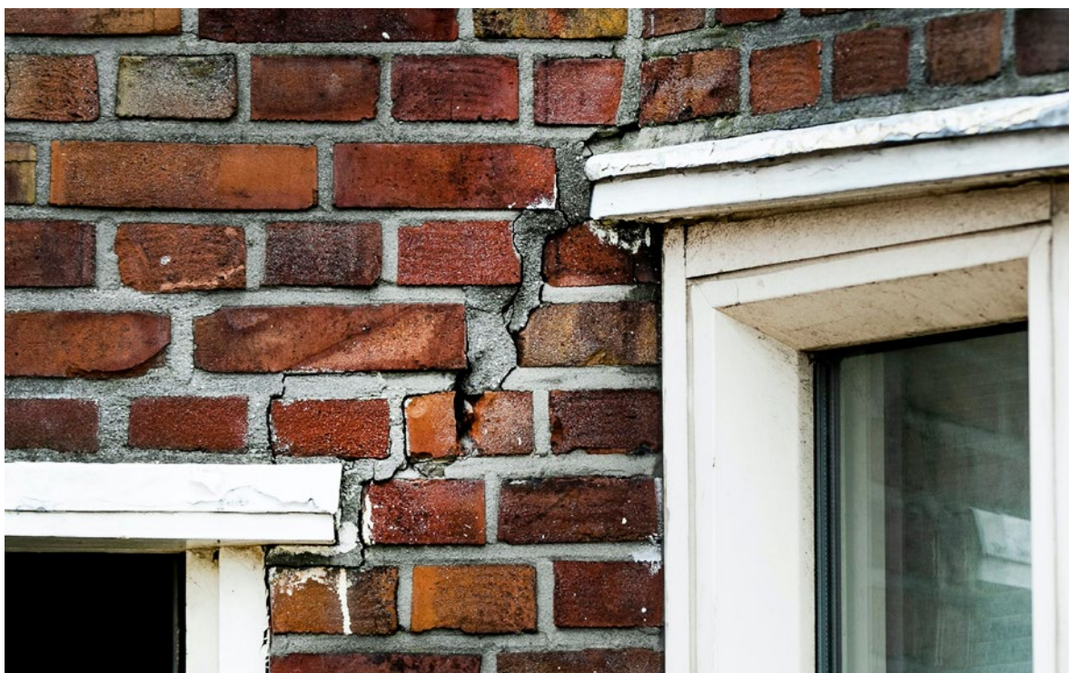
Figuur 1. Een woning die verzakt door funderingsproblemen (ANP, Remko de Waal)
