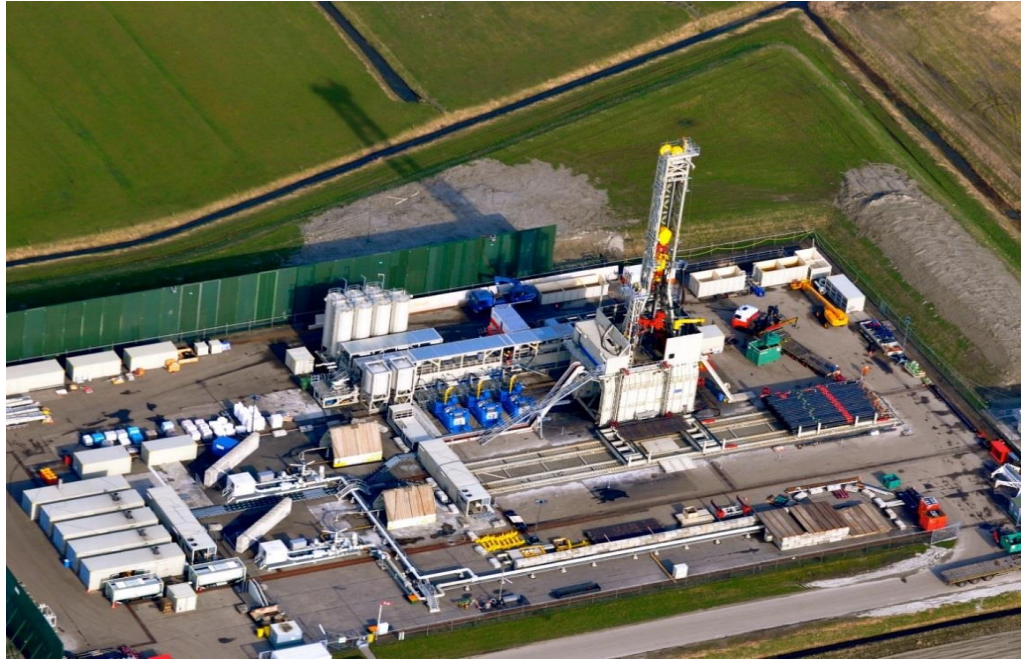
Figuur 2.2 Boorinstallatie inclusief boortoren en geluidswanden (bron: MER Gasboring en gaswinning Ternaard)
