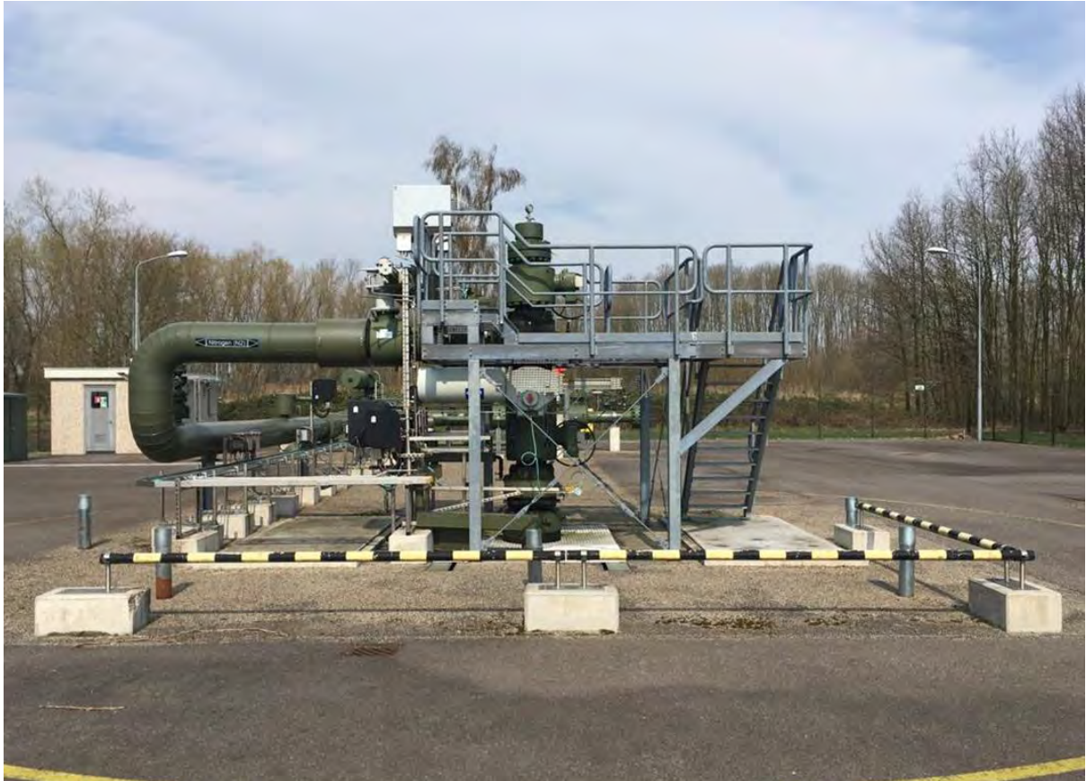
Figuur 21 Foto Wellhead/X-mass tree
