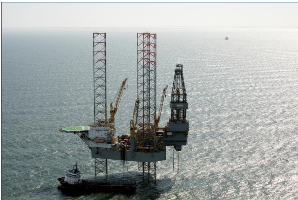
Abbildung 2- 45: Selbsthebende Bohranlage am Standort der Plattform N07-04A (2018). Die Bohranlage befindet sich auf der rechten Seite der Plattform. (© Foto & Video Honey)
