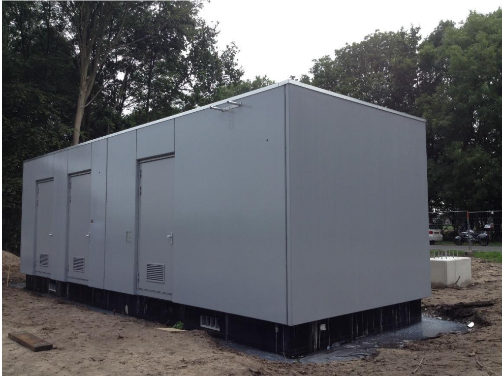
Figuur 4 Foto voorbeeld schakelkast
