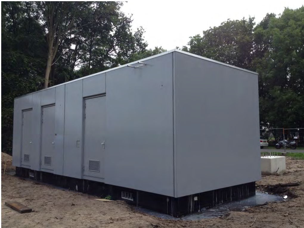
Figuur 3.1 Voorbeeld schakelkast
