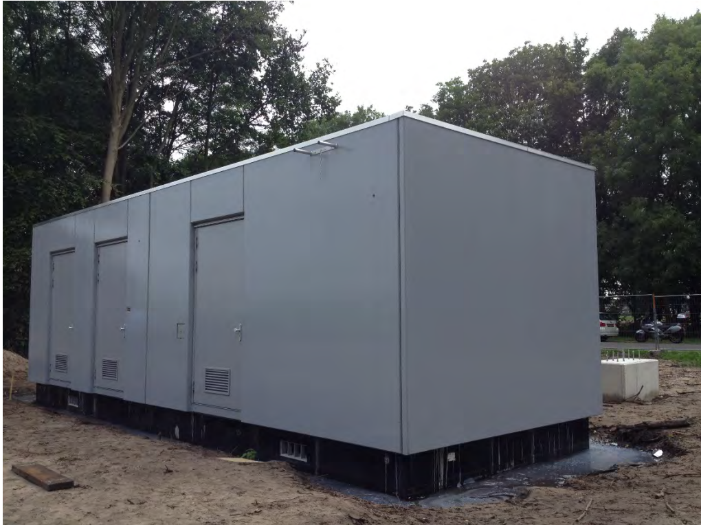
Figuur 3 Foto voorbeeld schakelkast
