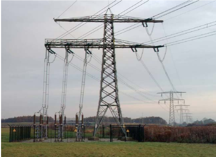
Figuur 20 Opstijgpunt met overgang ondergrondse kabels naar bovengrondse lijnen buiten hoogspanningsmast
