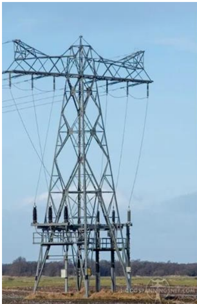
Figuur 19 Opstijgpunt met overgang ondergrondse kabels naar bovengrondse lijnen in hoogspanningsmast
