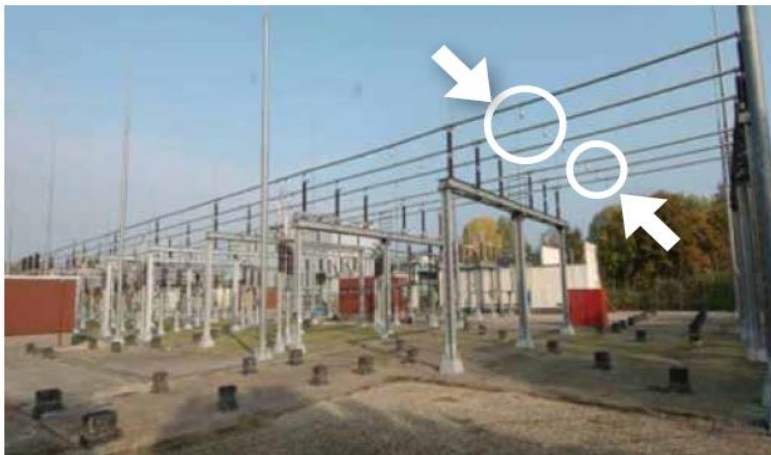
Figuur 4 Afbeelding dubbel hoofdrail (rail A en rail B) in bestaand hoogspanningsstation
