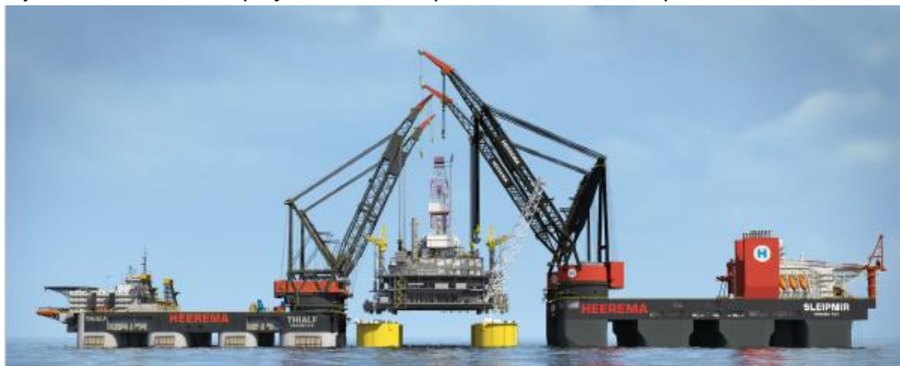
Figuur 1-2 Bovenbouw ophijsen met behulp van twee kraanschepen (hier: "Sleipnir" en "Thialf")
