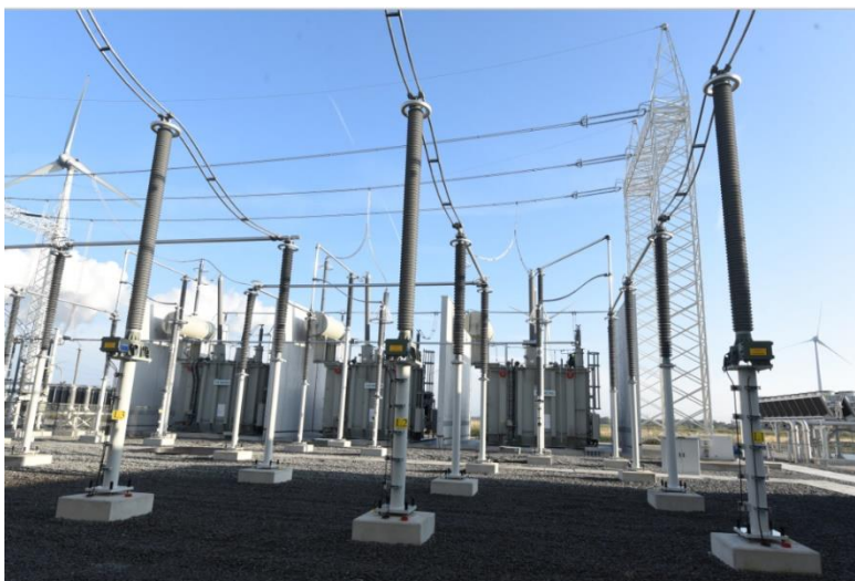
Figuur 1-12 Hoogspanningsinstallatie in de open lucht
