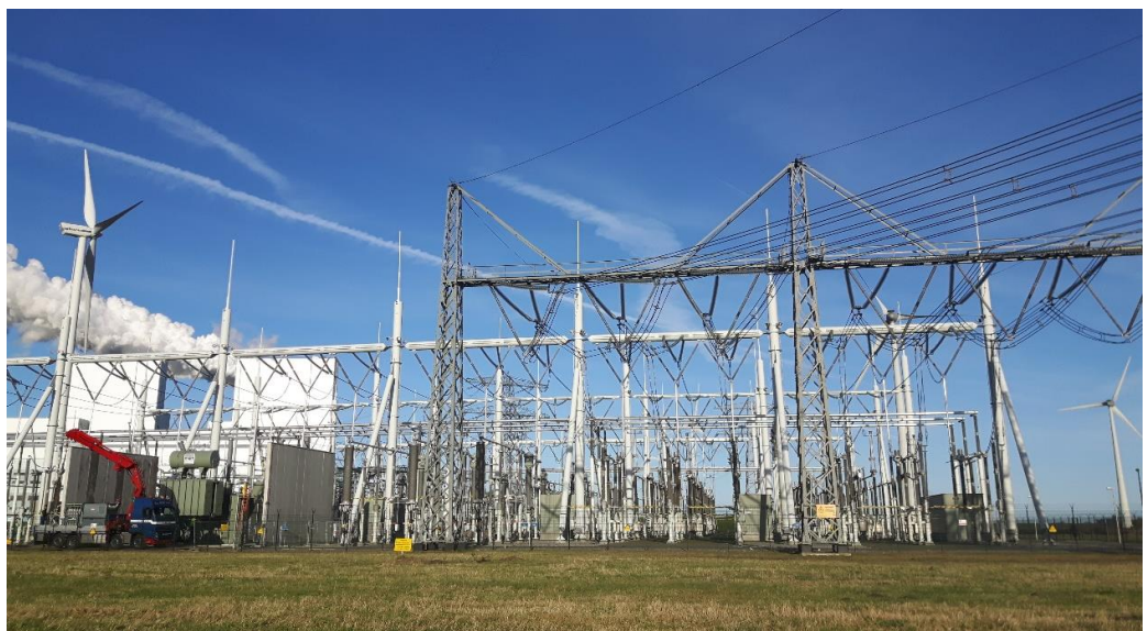
Foto 2: Hoogspanningsstation Eemshaven Oudeschip
