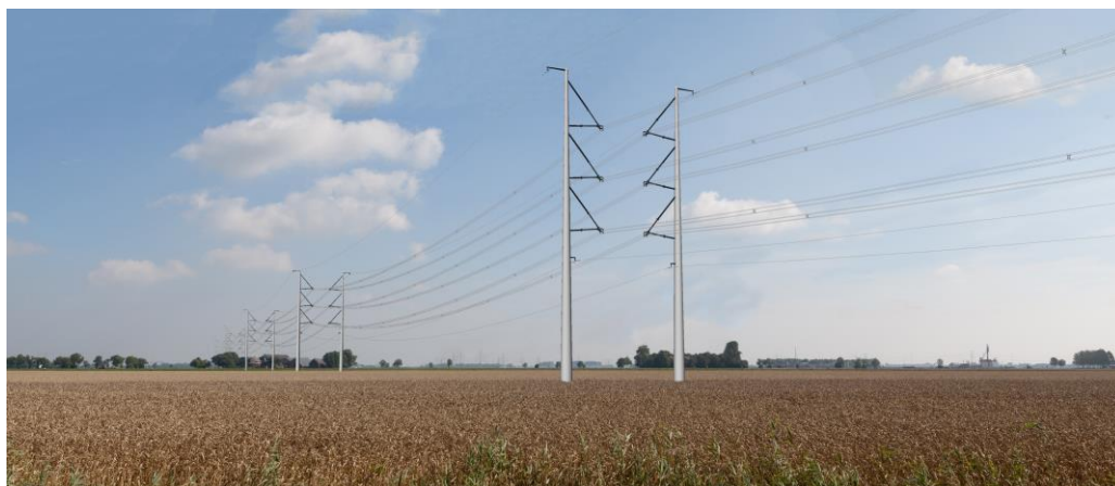
Foto 3: Wintrackmast met 2 circuits 380 kV
