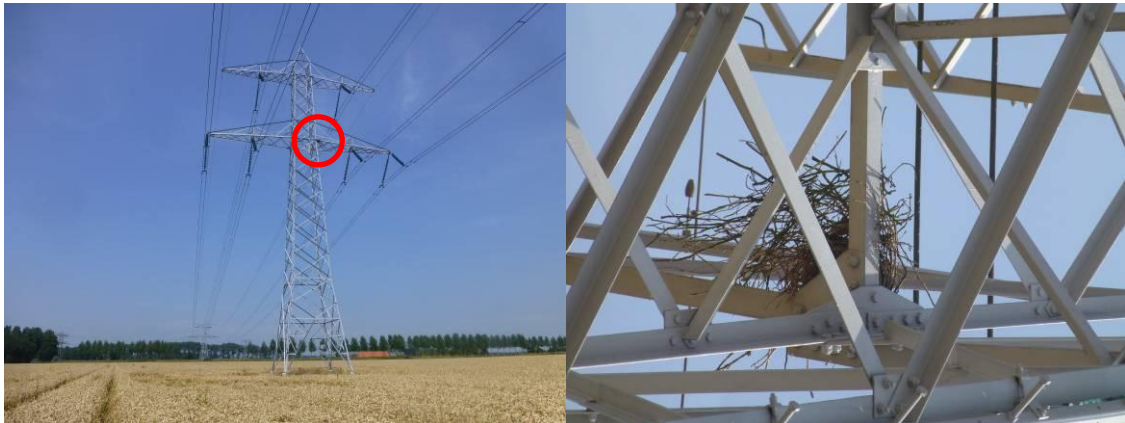
Figuur 3N. Aangetroffen buizerdnest op een te verwijderen mast te Heinkenszand.
