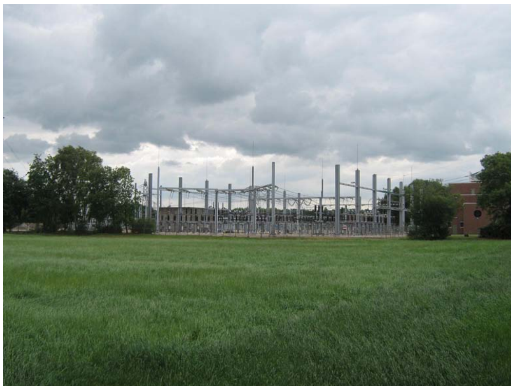
Foto 1. Trafostation langs de Veenslootweg aan de zuidkant van het tracé van de kabelbundel
