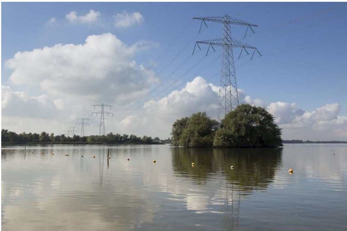
Figuur 4 Indruk van de bestaande 380kV-verbinding tussen Diemen en Lelystad.
