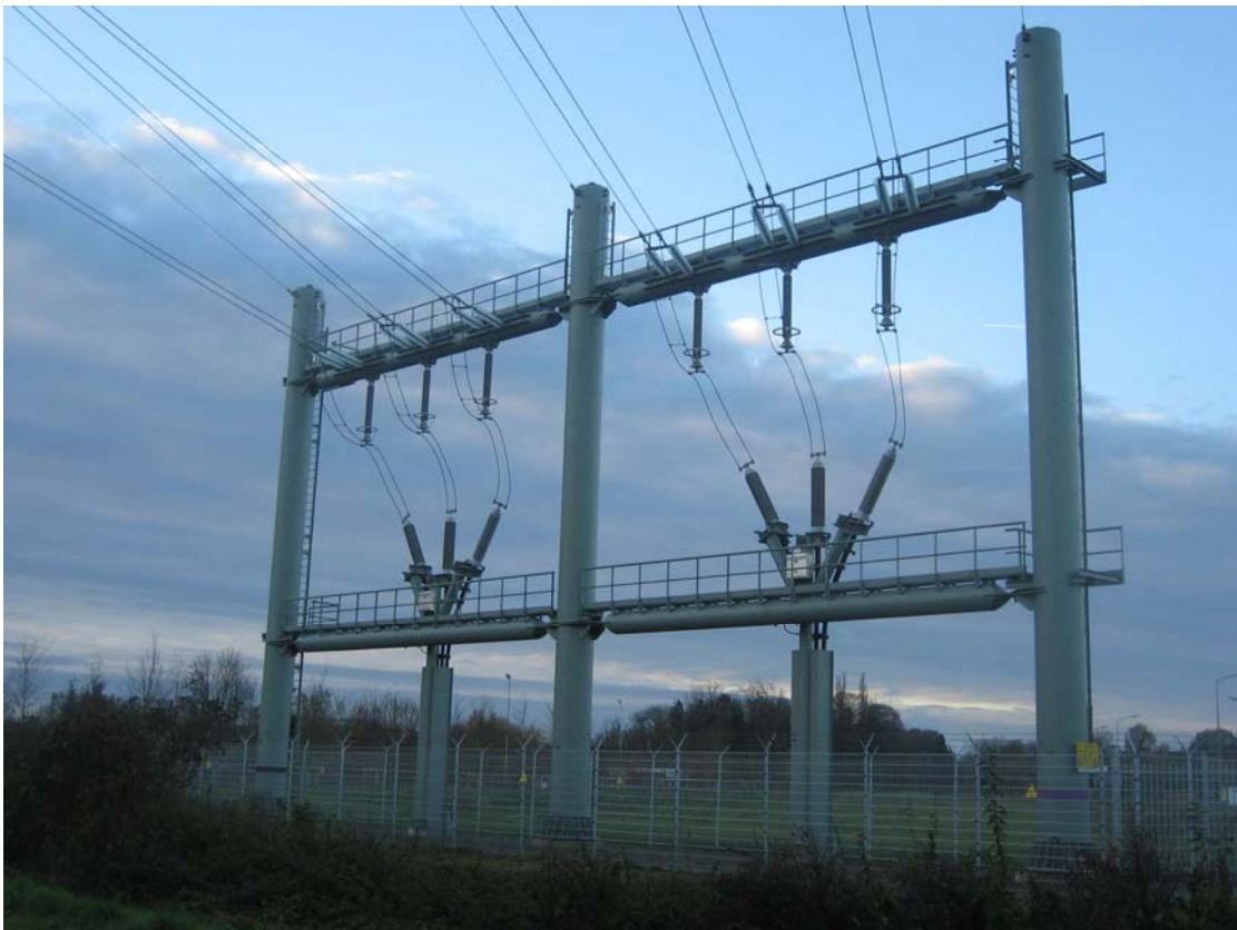
Figuur 2.6 Opstijgpunt door middel van portaalmasten (Willem Annapolder)
