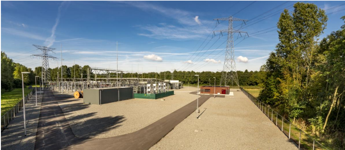
Afbeelding 5.3 Referentiebeeld van een bestaand, vergelijkbaar transformatorstation
