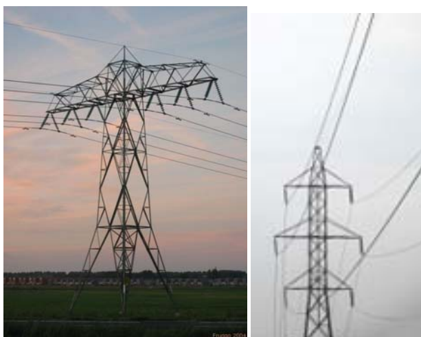
Figuur 5-2 Voorbeeld van een 2 circuit verbinding met 1 brede traverse (links) en een 2 circuit verbinding met 3 traversen
