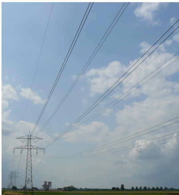
Figuur 5-6 Voorbeeld van een 150 kV verbinding met gebundelde fase draden (per twee) zonder afstandhouders
