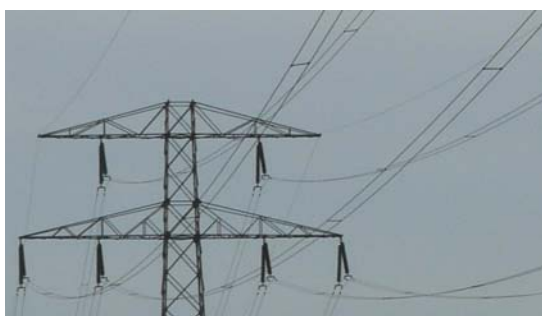
Figuur 5-7 Voorbeeld van een 150 kV verbinding met twee gebundelde fase draden met daartussen dunne, horizontale, afstandhouders
