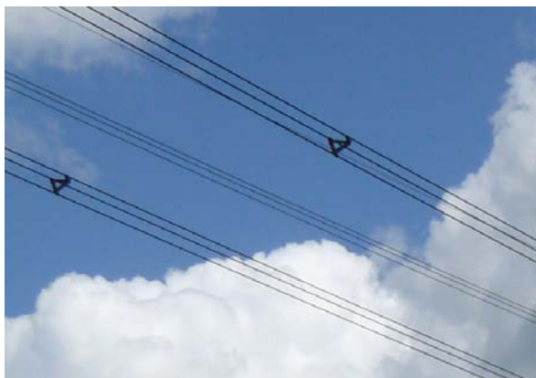
Figuur 5-8 Voorbeeld van een 380 kV verbinding met drie gebundelde fase draden met daartussen relatief dikke, driehoekige, afstandhouders
