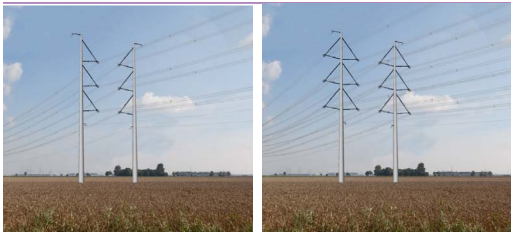
Figuur 3.1 Deelgebied 1 en 2, van links naar rechts: tijdelijke situatie (2 circuits 380 kV) en eindsituatie (4 circuits 380 kV)
