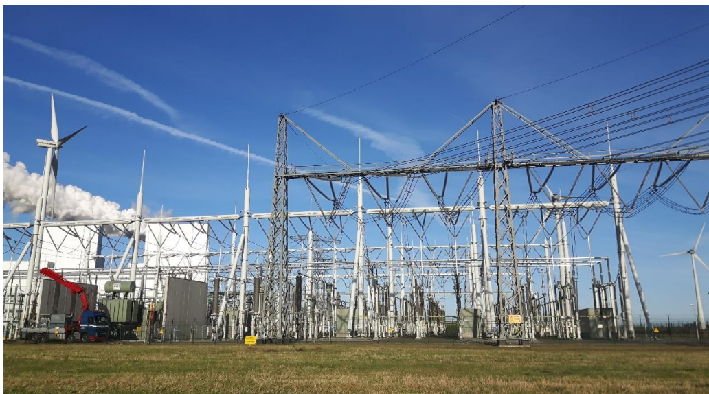
Foto 2: Hoogspanningsstation Eemshaven Oudeschip
