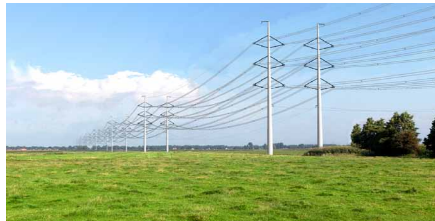
De vier circuit Wintrack mast
