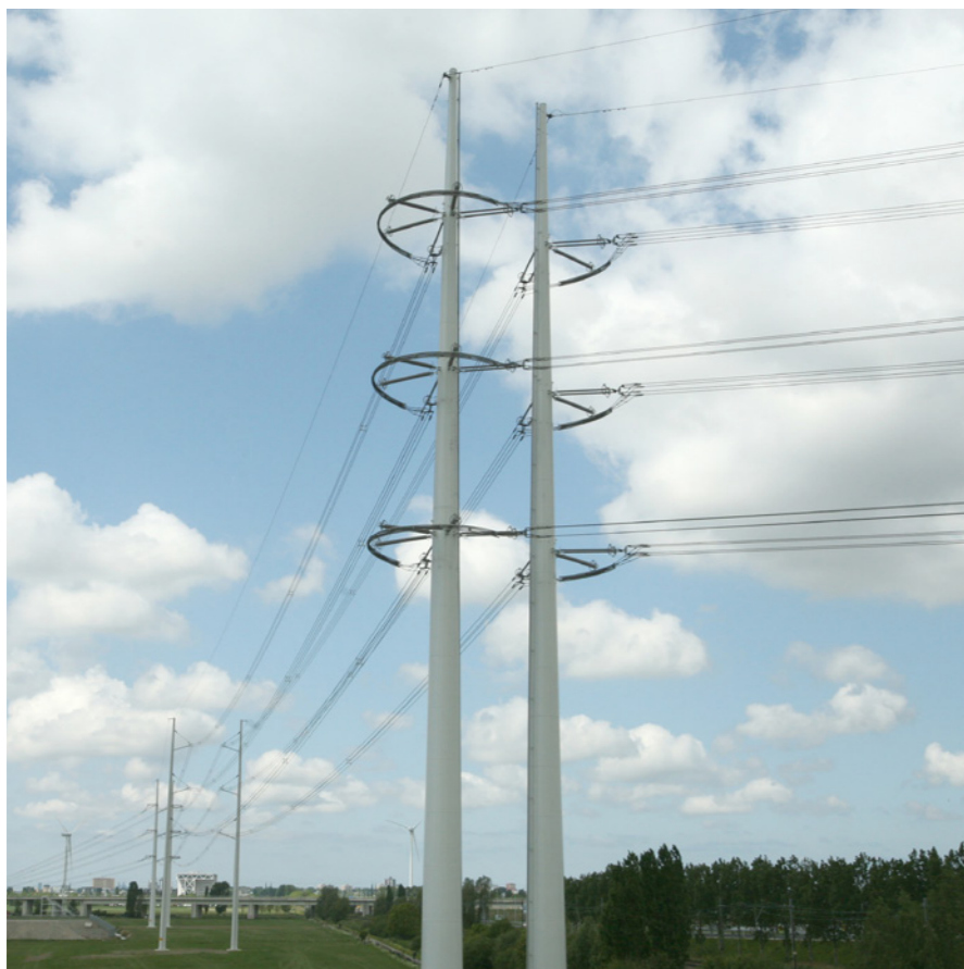
Highstep klimrail (t.b.v. onderhoud) in lijn met de verticaliteit van de masten
