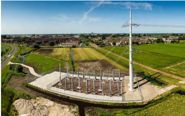
Afbeelding 3 Opstijgpunt 380 kV (opstijgpunt Pijnacker langs de N470 (richting hoogspanningsstation Bleiswijk))
