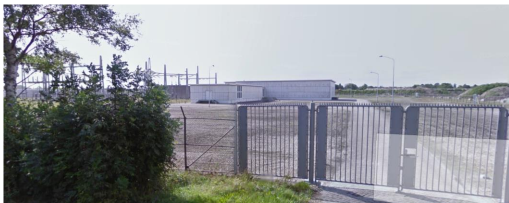
Figuur 2.1 Huidige situatie op het terrein van trafostation Veendam
