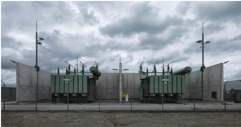
Figuur 9.13 Foto van een vergelijkbaar trafostation in de Noordoostpolder
