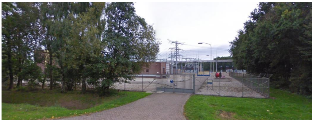
Figuur 2.1 Huidige situatie op het terrein van trafostation Meeden ter plaatse van het plangebied (links het bestaande gebouw en rechts de bestaande bosschage)
