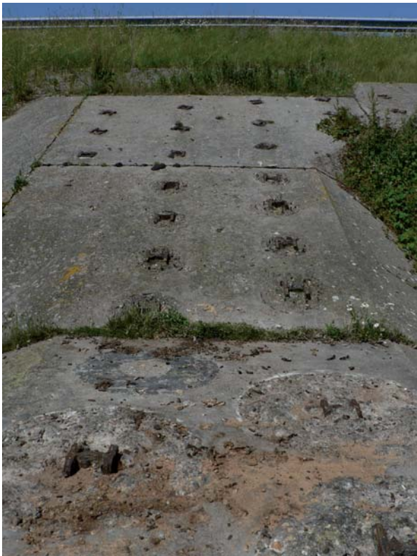
Figuur 22. Onderste deel van tankversperring met de twee platen waarop de balken in een betonnen omhulsel hebben gestaan.
