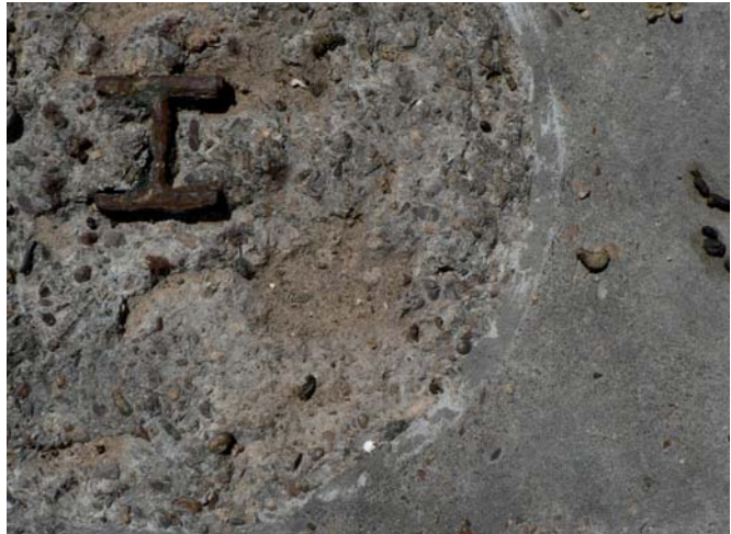
Figuur 23. Detail van I-balk in opgevulde ronde uitsparing met een afdruk langs de rand.
