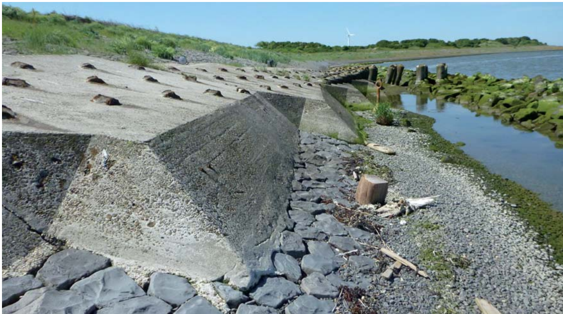
Figuur 15. Zeezijde van betonplaten met sporen van bekisting en aanwijzing voor het lokaal storten van beton.
