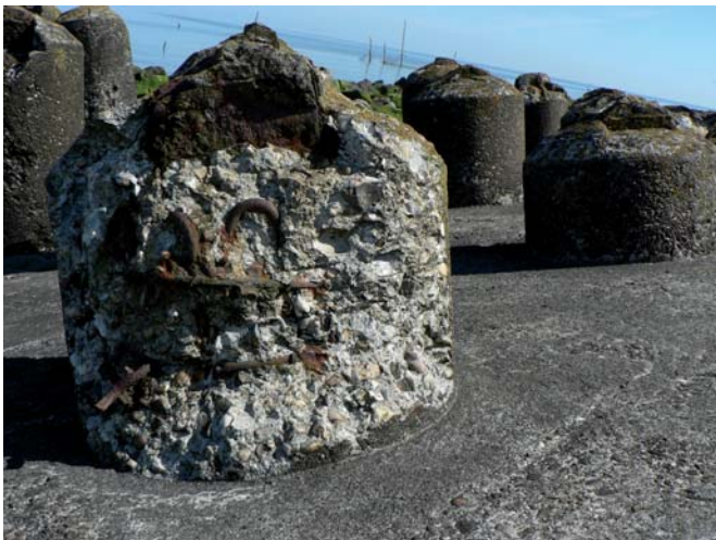
Figuur 18. Aangetast betonnen omhulsel van I-balk dat wapeningsijzer laat zien.
