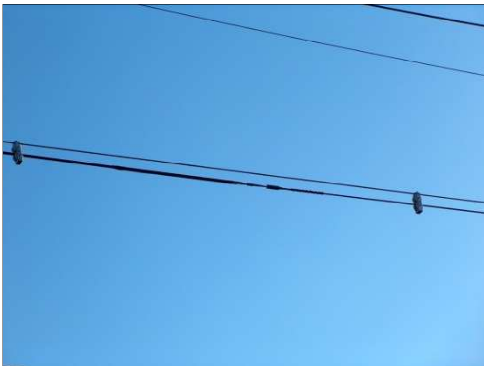
Figuur 9 Koppeling van de OPGW geleider en de staaldraad
