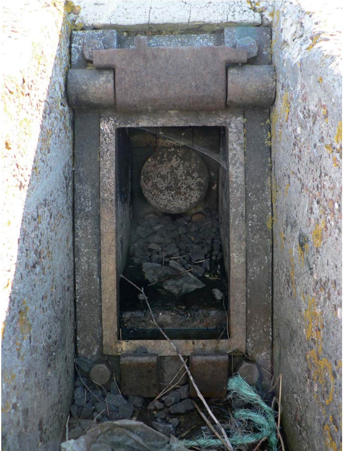
Figuur 9. Detail van afvoer met (afgebroken) tralievormige klep en klep op rioolbuis.
