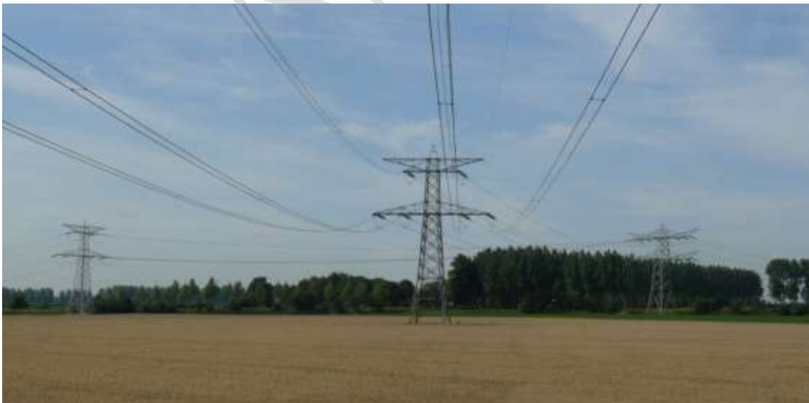
Foto 2 Bestaande 150kV-verbinding in het landschap van deelgebied 1. Bestaande 150kV-verbinding; rechts 4 circuits vanaf Borssele, op de voorgrond 2 circuits richting Goes, op de achtergrond links 2 circuits naar Zeeuws-Vlaanderen. Kijkrichting ongeveer zuidwest
