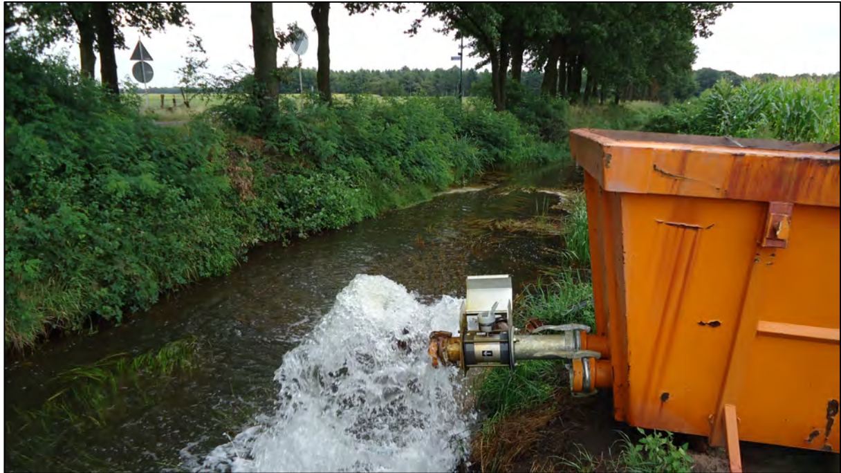
Figuur 5 - Uitstroomvoorziening welke de stroomsnelheid reduceert en richting verandert.
