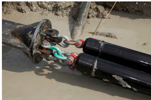
Trekkep, bundel PE pijpen
