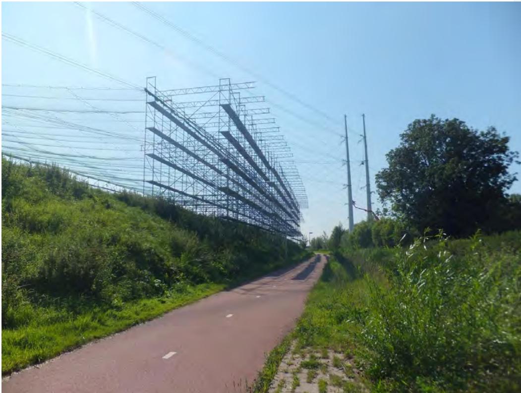
Figuur 2 Foto Juk N470 Randstad 380 kV Zuidring project
